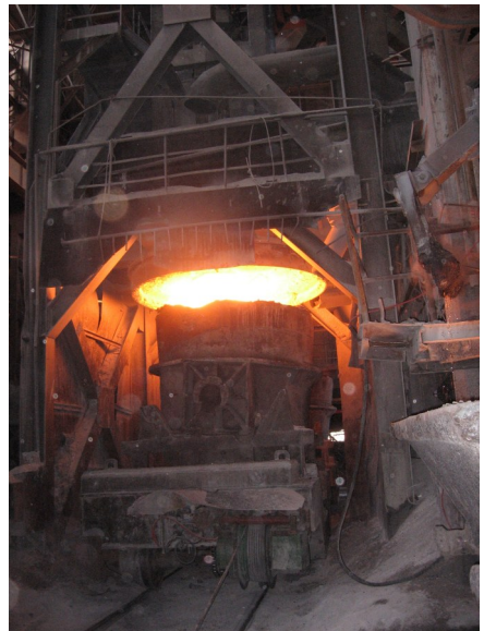
图 3 改造后铁水脱硫装置实物图
