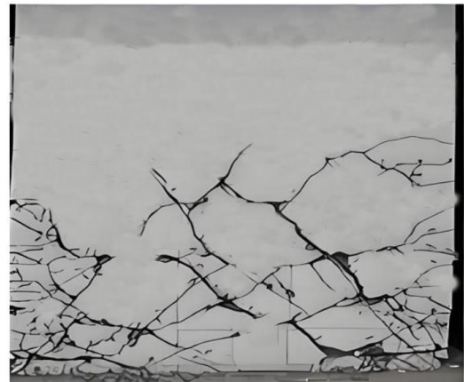
(a)钢筋混凝土裂缝破损
