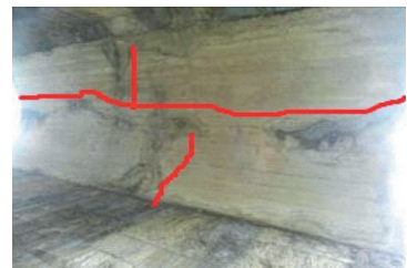
图7 2#腹拱横向、纵向裂缝
