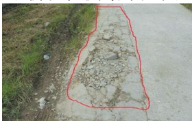
图4 铺装层压碎、坑洞
