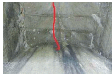
图6 3#拱波纵向裂缝、渗水泛碱
