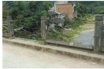
图5 栏杆缺失变形
